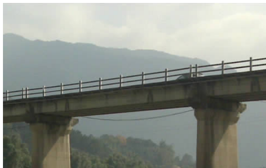
图2 改造前旧桥状况
