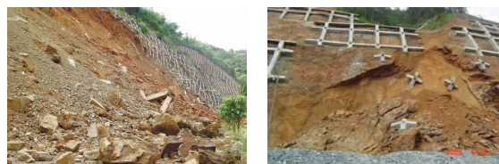
(a) 边坡垮塌实景图
