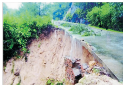
(b) 边坡崩塌
